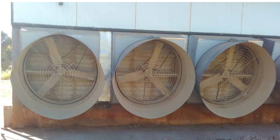
Fig. 5- Ventiladores de exaustão
